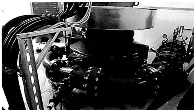
▲オーストリアの小型水力発電所タービン(このサイズは日本にはない)
